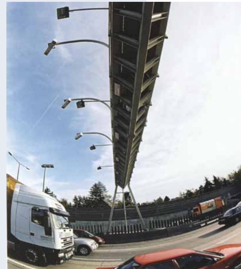
Distance-based toll portal for trucks Portique pour péage kilométrique poids lourds
